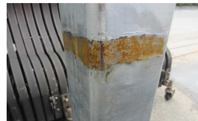
部分的な腐食
